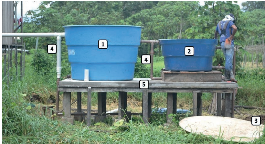
Figura 2. O sistema da fossa alta comunitária instalado e identificação de seus componentes.
