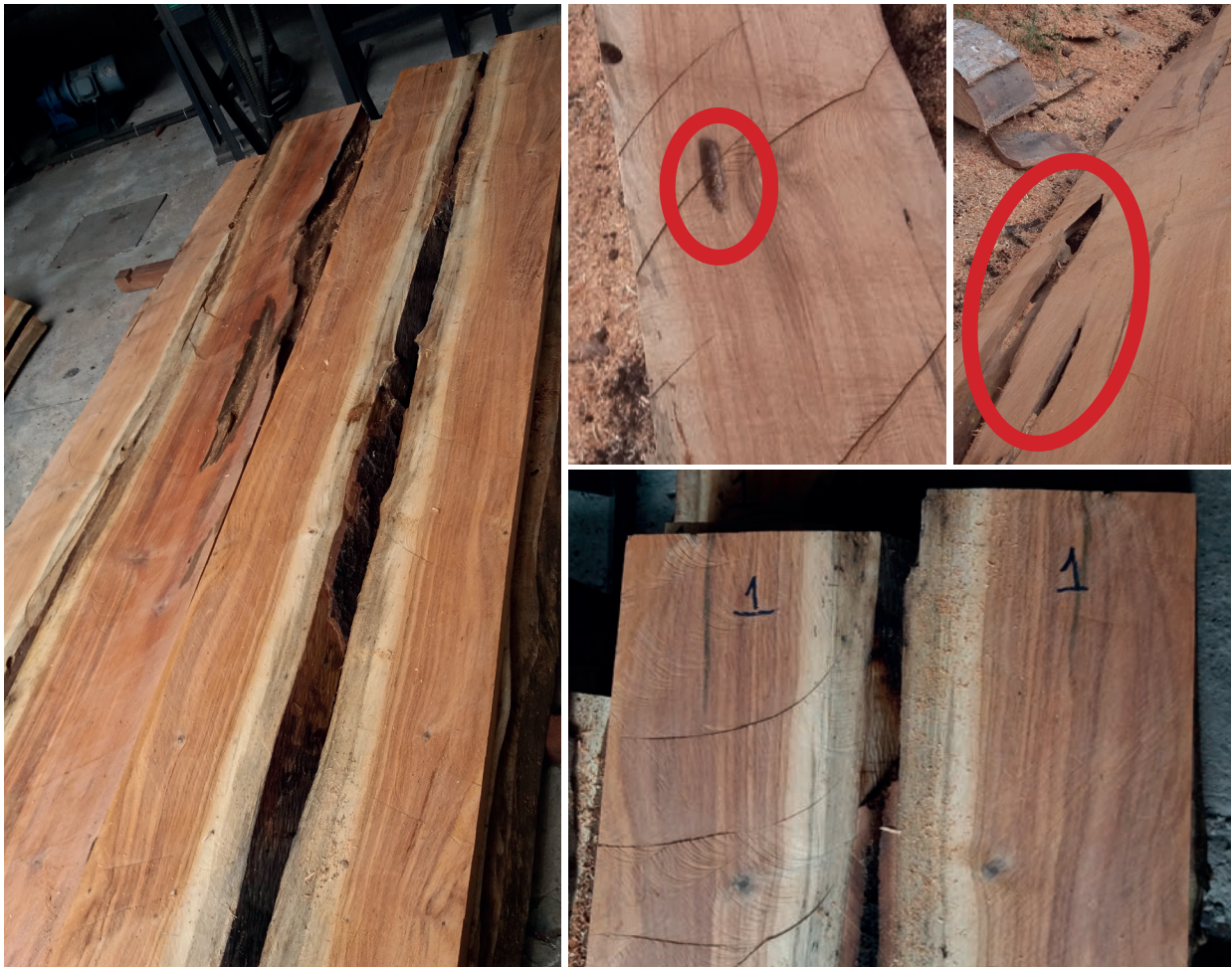
Figura 4. Demonstração das peças de madeira obtidas após o desdobro das toras, sendo destacados alguns defeitos ocasionados por organismos xilófagos.
