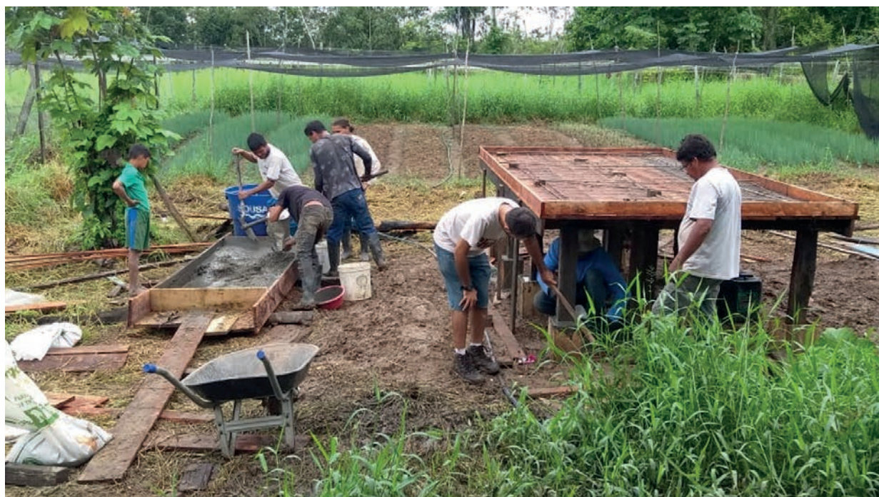
Figura 6. Participação social: moradores trabalhando na obra de instalação da fossa alta comunitária.
