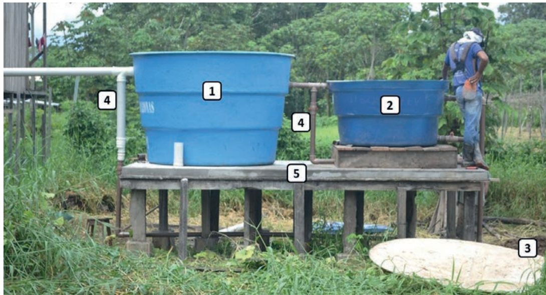
Figura 2. O sistema da fossa alta comunitária instalado e identificação de seus componentes.
